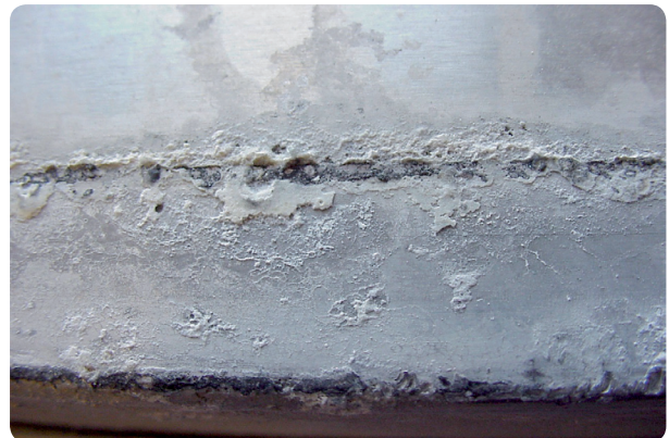
Galvanisk korrosion på aluminiumlåge forårsaget af gummitætning
