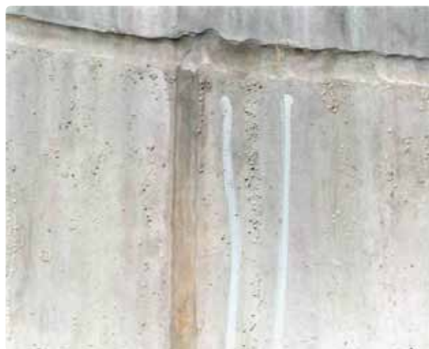
Grubetærringer i tanksvøb
