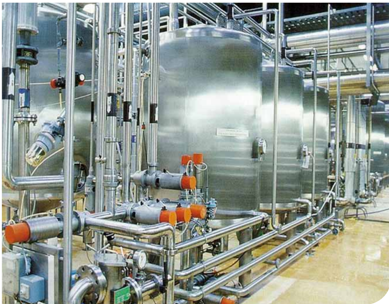
Procesanlæg i rustfrit stål (Foto: Sandvik)
