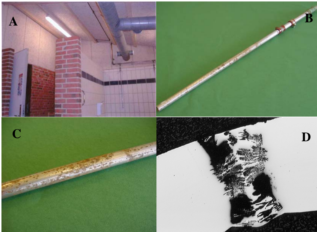
Figur 1. Brugsvandsrør gennemtæret udefra som følge af kloridforurening fra svømmehallen.
